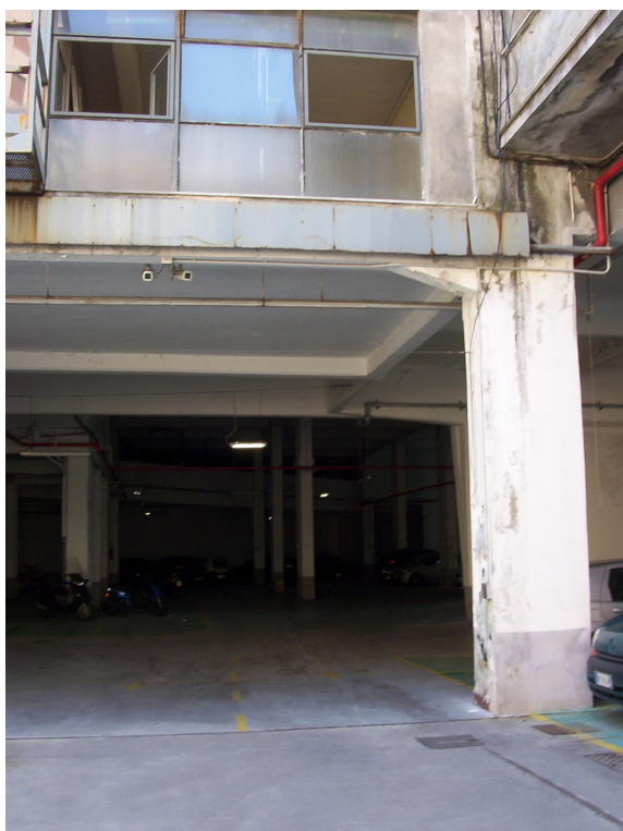
Foto 5 – Interno autorimessa da V. Lagaccio
